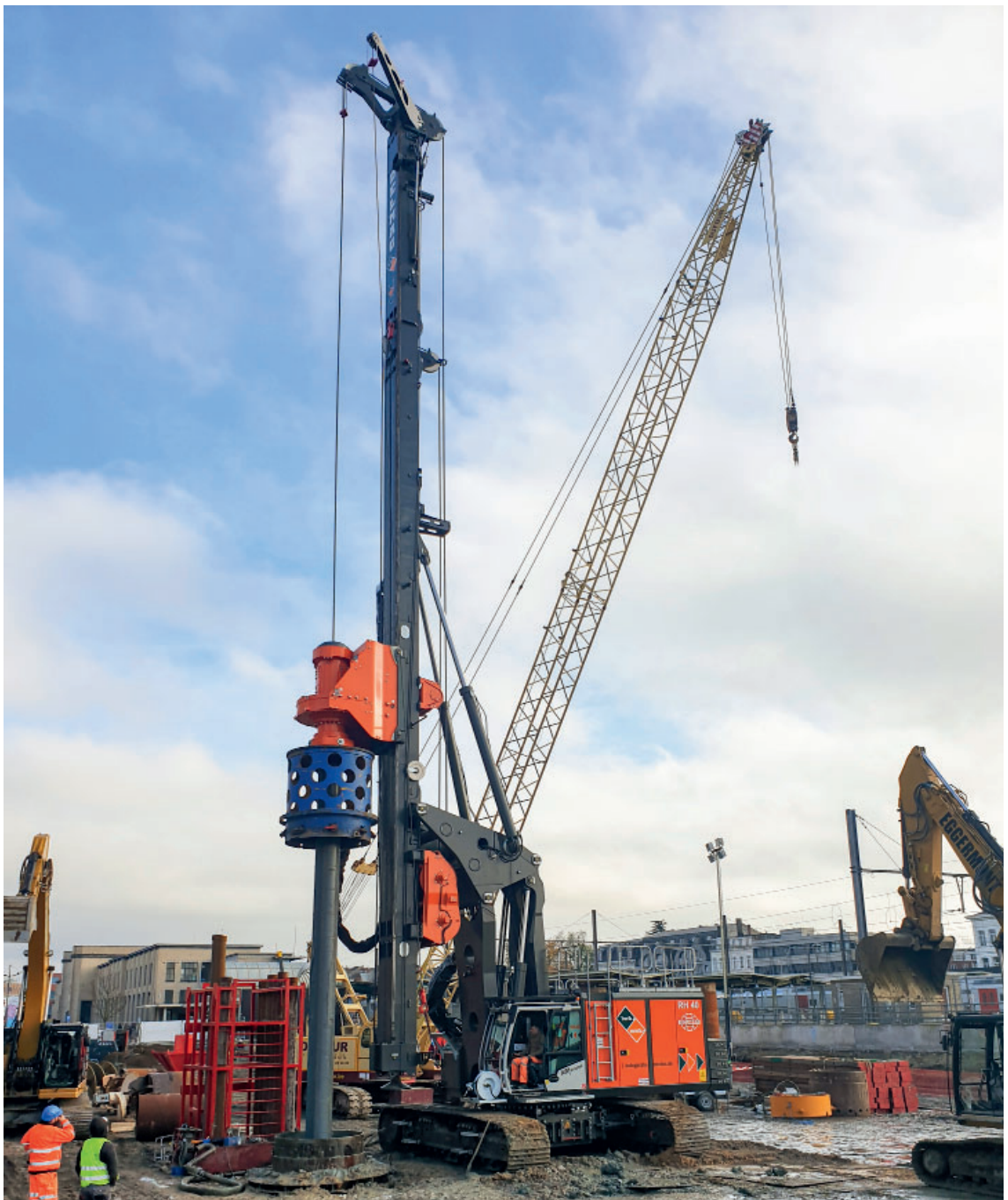
Das größte Modell der DELMAG Drehbohranlagen aufgebaut auf ABI Trägergerät T110D bei der Herstellung von Pfählen mit einem Durchmesser von 1800 mm und einer Tiefe von 40 m im Kellybohrverfahren.
