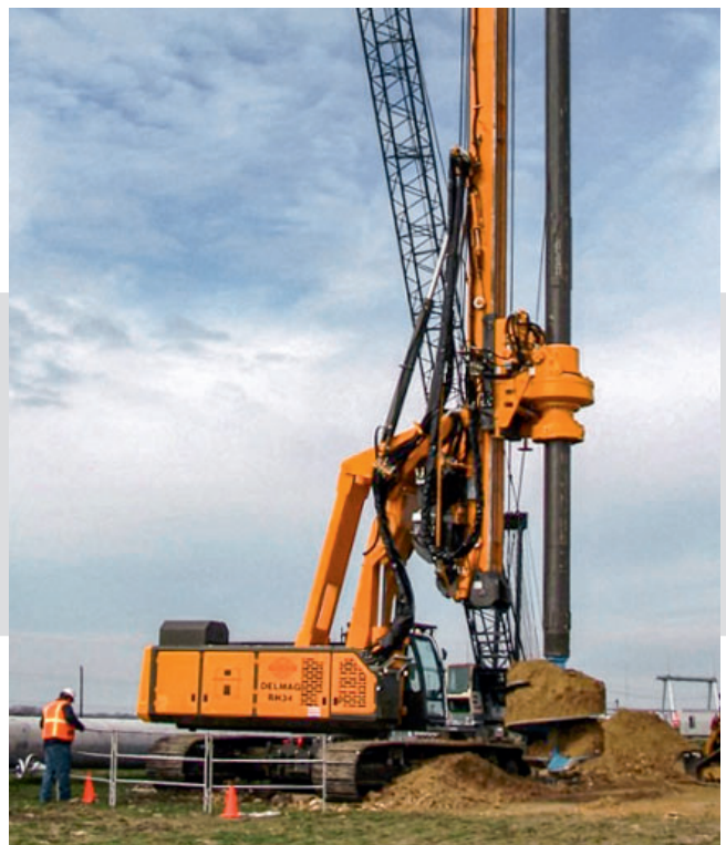
Unverrohrtes Kellybohren mit kurzem Mäklerfuß: Der kurze Mäklerfuß ermöglicht größere Durchmesser, da das Bohrwerkzeug unter dem Mäkler duchschieben kann.
